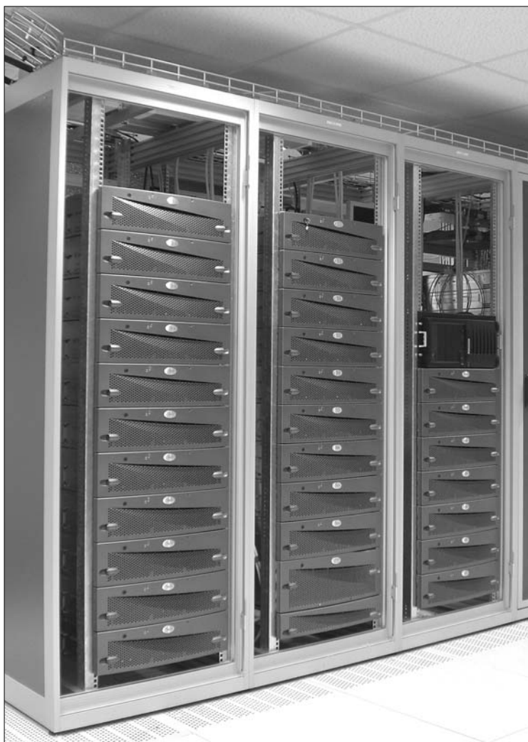
Abb. 1: Das größere der beiden Storage-Systeme (am primären Standort)
