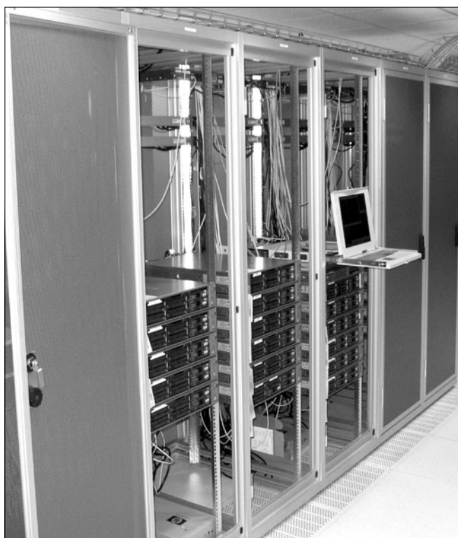
2006, in einem Serverraum des ZID: EDV-Schränke ( Racks ), in denen jeweils mehrere Server untergebracht sind
