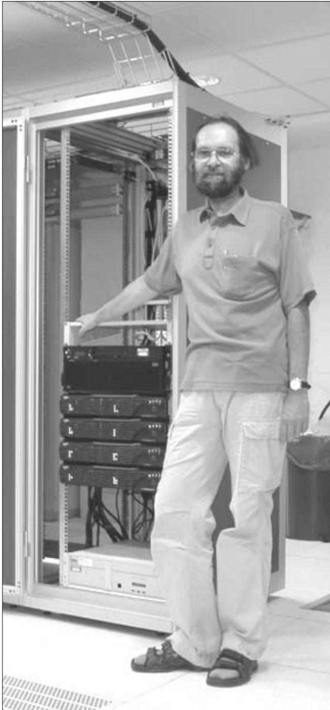
Systemadministrator Peter Marksteiner neben dem neuen Unet-Fileserver FS1.UNET.UNIVIE.AC.AT – jeder der vier Platteneinschübe des Servers enthält sechs SCSI-Platten zu je 146 GB und kann noch mit sechs weiteren Platten bestückt werden.
